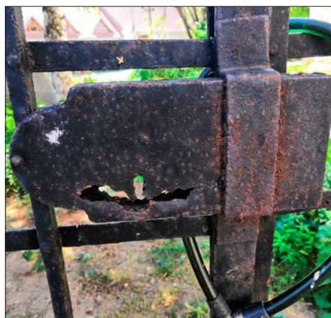
Detail brány před opravou
