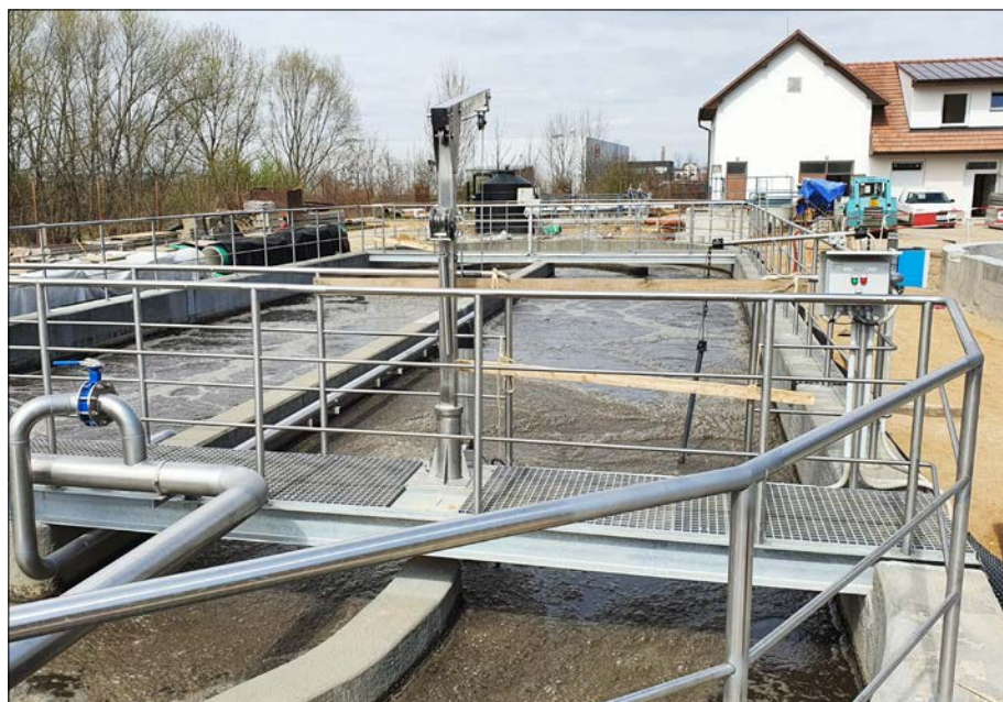
Nově vybudovaná aktivační nádrž I. linky
