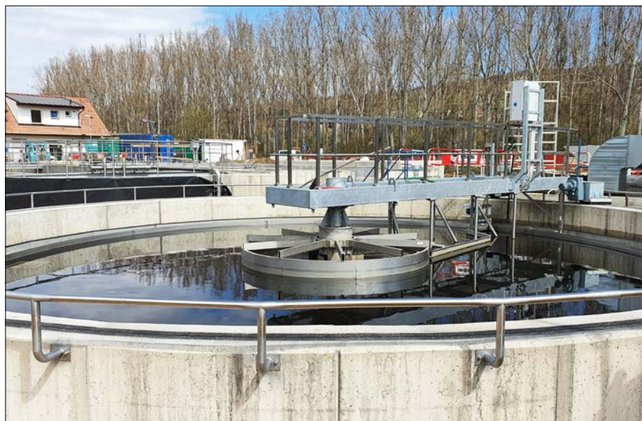
Nově vybudovaná dozovací nádrž I. linky
