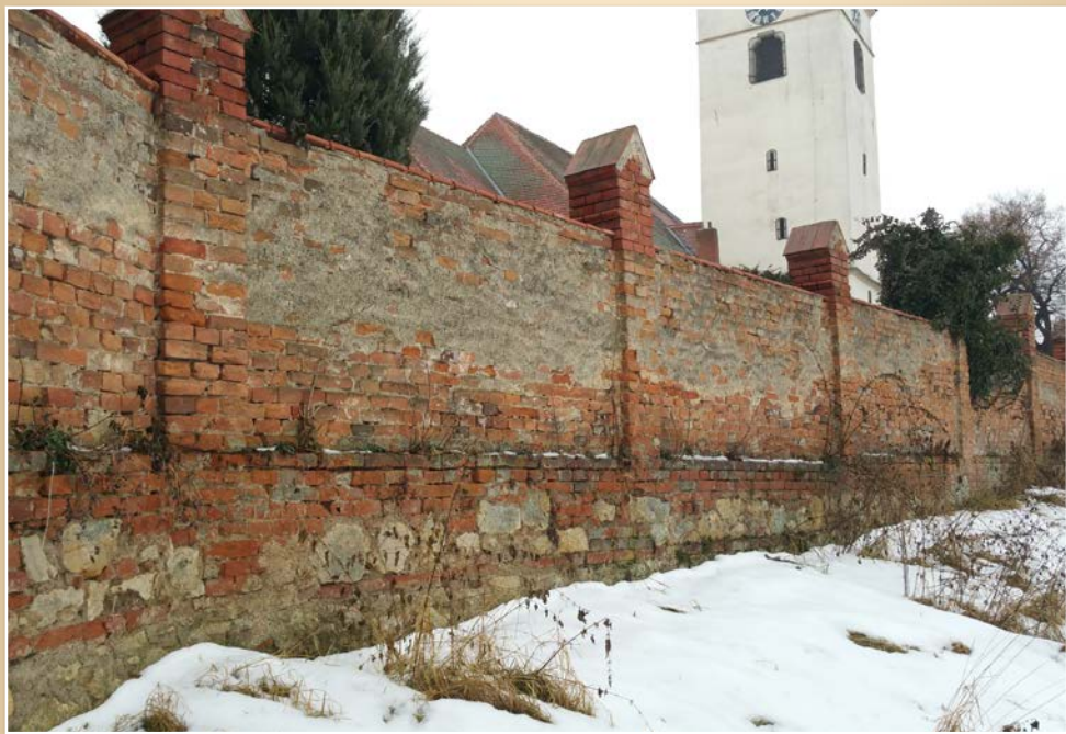
Hřbitovní venkovní zeď před opravou
